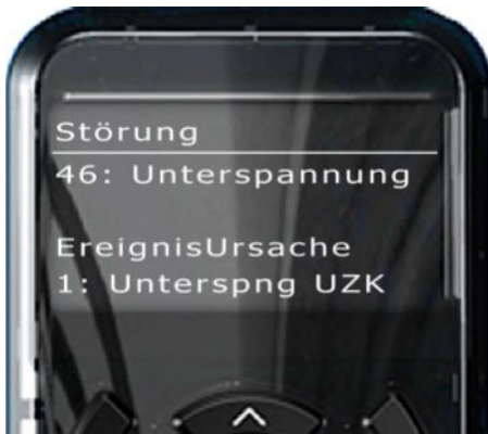
Abb. 85: Anzeige einer Störung am Display
